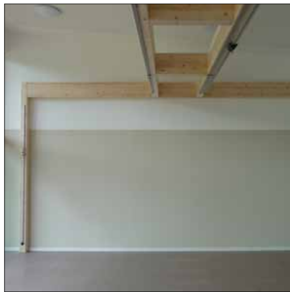
Bei instabilen Wänden
